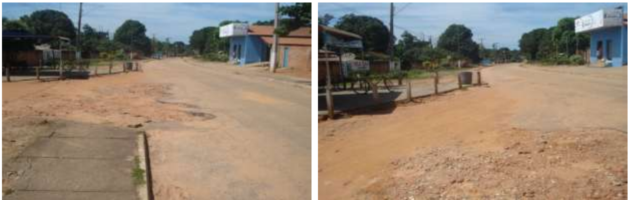
Danos ao asfalto na Rua Don Alano com Rua 7A
